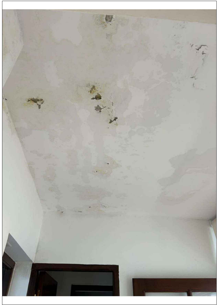
Parte de humedades a reparar
